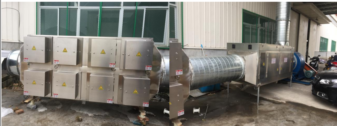
图3-1 废气处理装置
