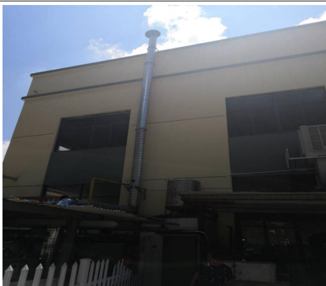
天然气燃烧废气排气筒
