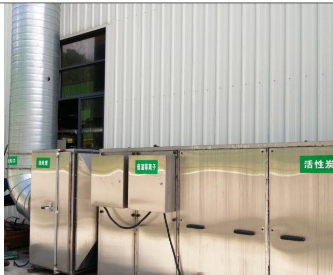
硫化废气处理设施
