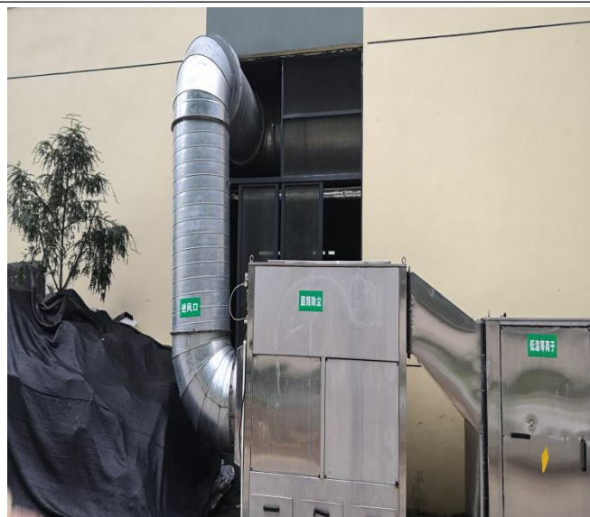
配料密炼开炼废气处理设施
